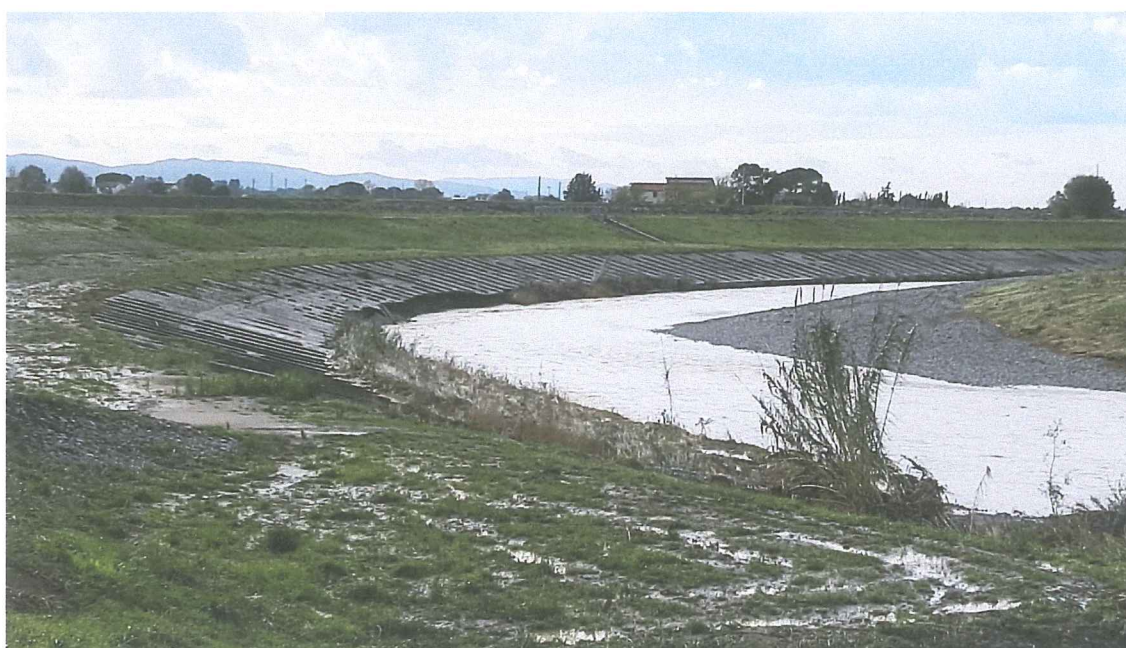
Foto 2 – Depositi in alveo Fiume Albegna (DX idraulica)
