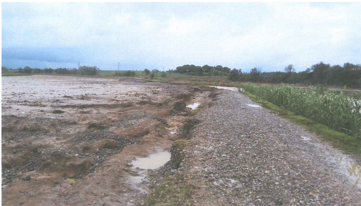
Foto 1 – Erosioni spaltone Fiume Albegna (DX idraulica)
